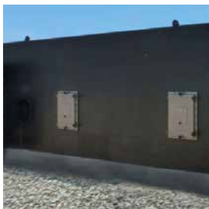
Langwäscher integriert im Biofilter
